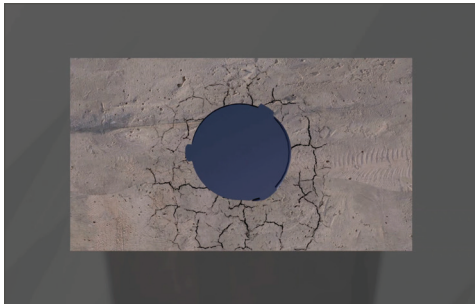
03 콘크리트의 철근이 팽창하여 균열이 발생
