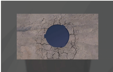
03 콘크리트의 철근이 팽창하여 균열이 발생
